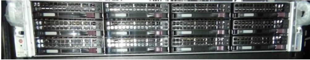
Slika 1.1. Poslužitelj u poslužiteljskom ormaru
